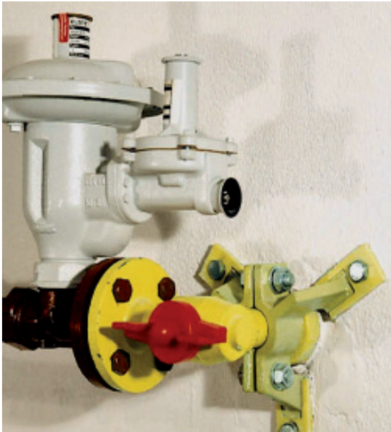
Abbildung 209: Installationsbeispiel: aufgeschraubte Ausziehsicherung, kein Festpunkt (Bildquelle: DVGW Bildungswerk – Schulungsunterlage TRGI-Trainer)
