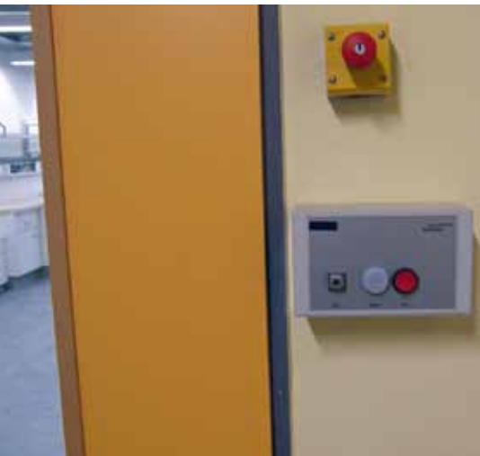
Bedieneinheit und Schlüsselschalter sind außerhalb der Laborräume im Flur platziert.
